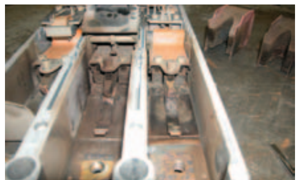
Figura 4. Centro de carga con contacto derretido.
