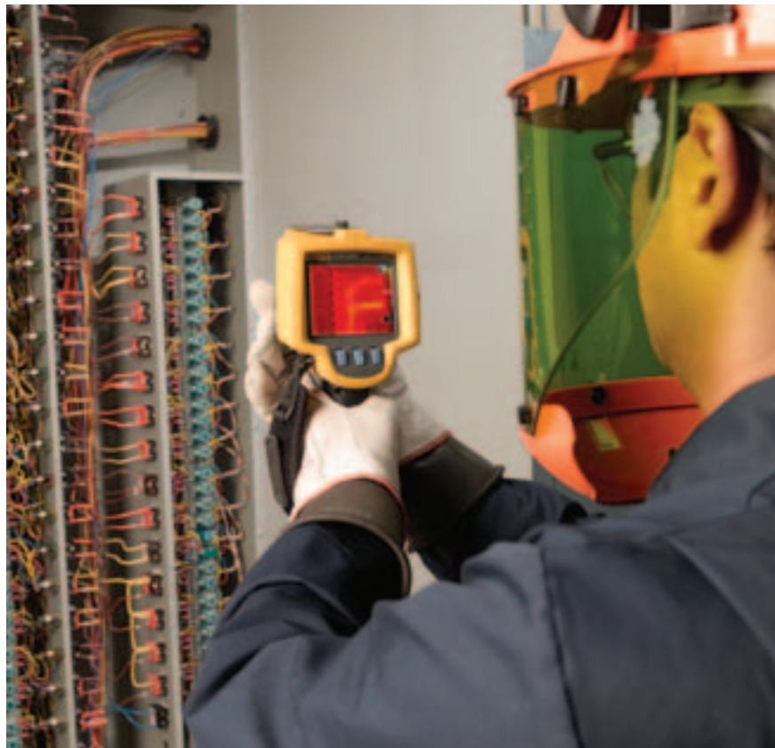
Inspección de circuitos de control de iluminación con un lector de imágenes térmicas Fluke Ti25 y un EPP adecuado.
