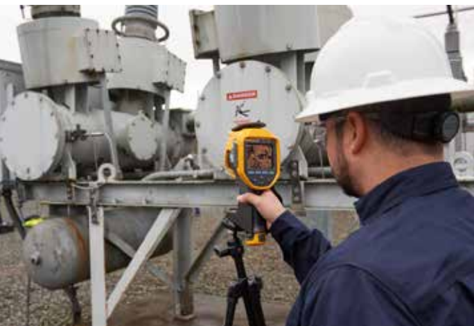
Figura 1. Un ispettore usa il rilevatore di gas Fluke Ti450 SF6 per ispezionare i collegamenti imbullonati.
