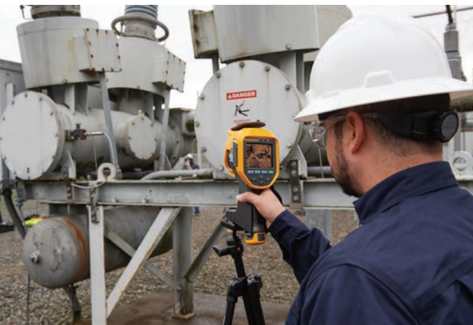
Figura 1. Un inspector utiliza el detector de gas Fluke Ti450 SF6 para inspeccionar conexiones atornilladas.
