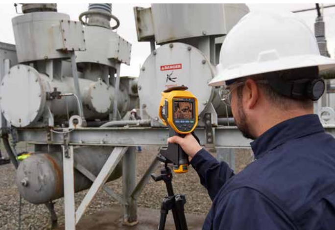
Afbeelding 1. Een controleur gebruikt de Fluke Ti450 SF 6 gasdetector voor het controleren van boutverbindingen.
