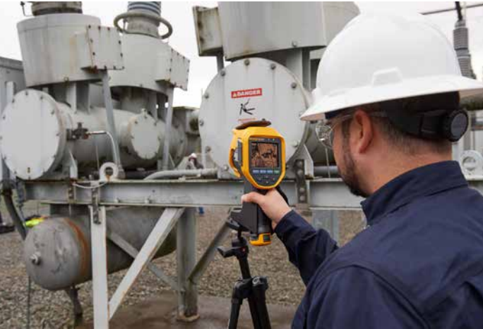
Şekil 1. Denetleyici, Fluke Ti450 SF6 Gaz Dedektörünü kullanarak civatalı bağlantıları inceliyor.
