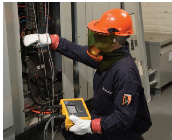
Rolf Zoeller, Electricista utiliza el Registrador de Alimentación Trifásico Fluke 1735 para realizar estudios de carga en los sistemas eléctricos del hospital. Vigilando de cerca estos sistemas ayudó al hospital a lograr su calificación ENERGY STAR.
