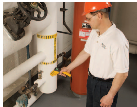
Darryl Dylla, HVAC/Gerente de la Central Eléctrica, utiliza un Termómetro Infrarrojo 62 de Fluke para chequear las trampas de vapor por todo el sistema de calefacción, ventilación y aire acondicionado.
