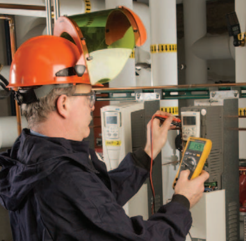
Jim Murphy, Capataz Electricista utiliza el 179 DMM de Fluke para observar señales de baja tensión en el recientemente instalado VFD para el sistema de vapor de más de 40 años de antigüedad.
