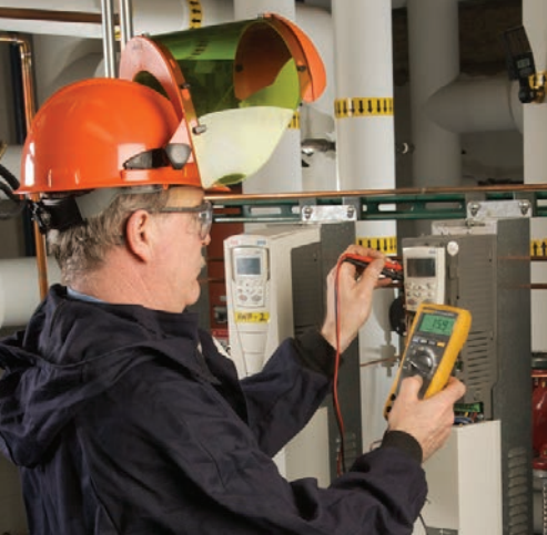
Jim Murphy, contramestre eletricista, usa o DMM Fluke 179 para examinar os sinais de baixa tensão no VFD recentemente instalado no sistema a vapor com mais de 40 anos de idade.
