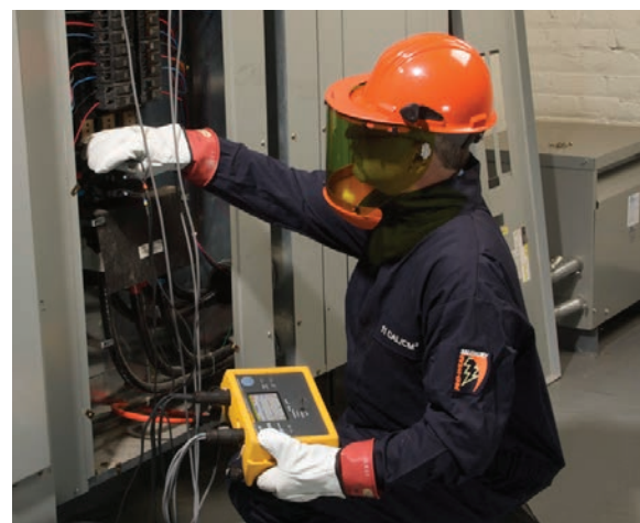
Rolf Zoeller, eletricista, usa o registrador de energia trifásica Fluke 1735 para alimentar estudos sobre os sistemas elétricos do hospital. A manutenção de um controle firme sobre esses sistemas ajudou o hospital a alcançar a classificação ENERGY STAR.
