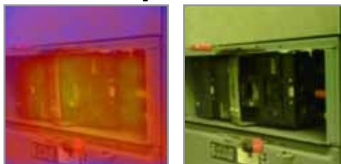
Temperatura operativa normale su un interruttore di importanza critica
