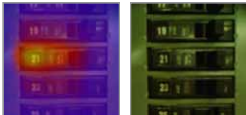
Перегруженные автоматические выключатели
