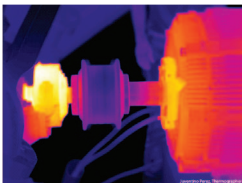
1. Identifiez les problèmes potentiels en utilisant une caméra à infra-rouge Fluke.
