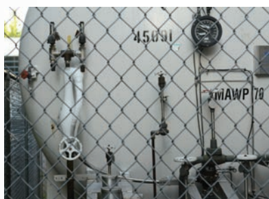
Trudne warunki w miejscach przeprowadzania inspekcji, wiele warstw komponentów
