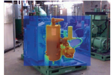
Compresor industrial, combinación
