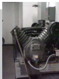
Compresor de aire – Totalmente visible
