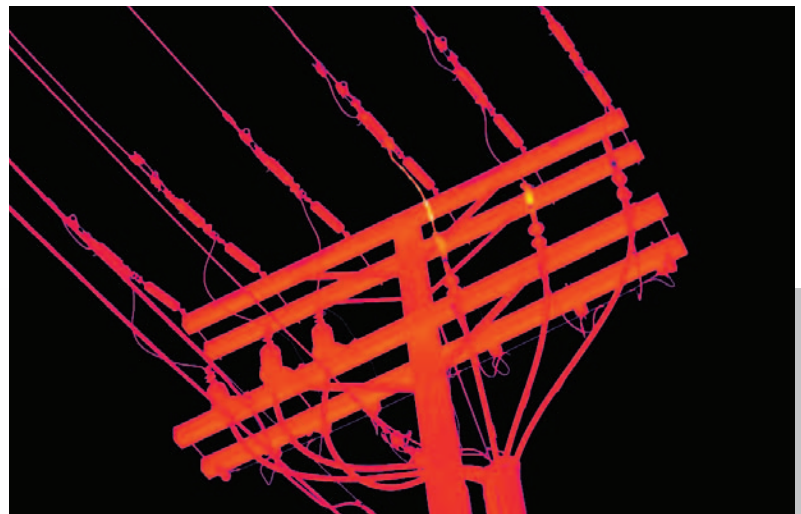
Líneas de distribución del servicio eléctrico
