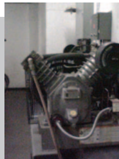
Compresor de aire – Totalmente visible
