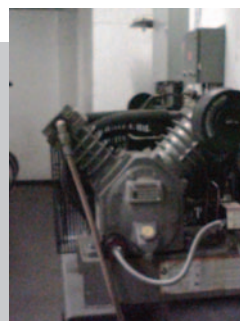
Compresseur d'air - Image visible intégrale
