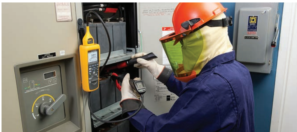
Utiliser le Fluke BT52X pour mesurer l'impédance lors de l'essai trimestriel de la résistance interne de la cellule/l'unité.
