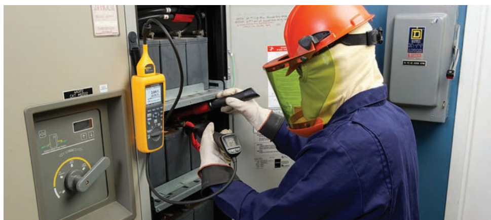
Uso del Fluke BT52X per misurare l'impedenza nel test trimestrale del valore resistivo interno della cella/unità.
