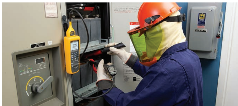
De Fluke BT52X gebruiken voor het meten van de impedantie, voor de driemaandelijke test van de interne weerstand van de cel/eenheid.
