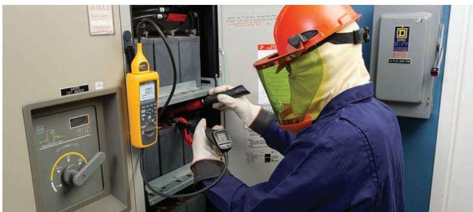
Bruk av Fluke BT52X til å måle impedans, for kvartalsvis testing av interne, ohmske verdier for celle/enhet.
