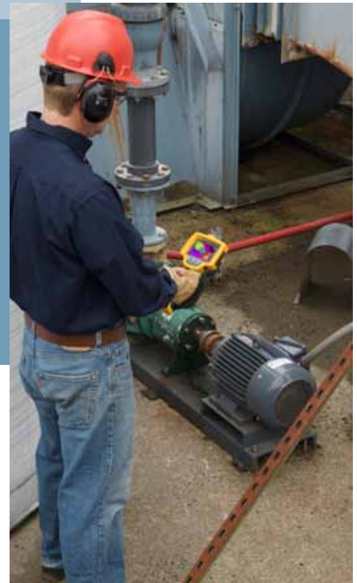
El aumento de calor se hace visible con una cámara termográfica Fluke Ti32, que capta imágenes bidimensionales de la temperatura superficial aparente de bombas y otros equipos.
