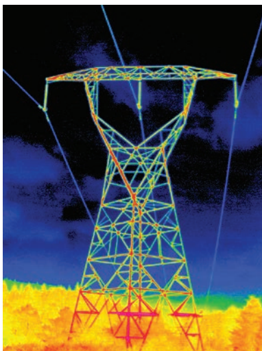
送電設備 (送電塔)
