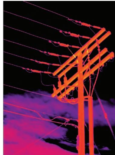
Kawat rusak dan resistansi tinggi utilitas listrik.
