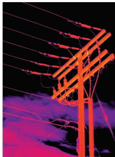
Cabos quebrados e alta resistência do fornecimento elétrico.
