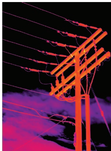
Обрыв многожильных проводников и высокое сопротивление в электрических коммунальных сетях.
