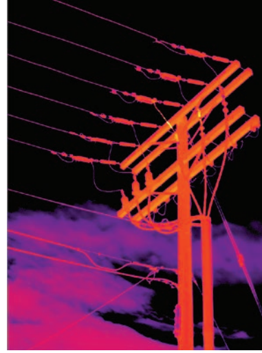
Elektrik hizmetleri kopuk tel ve yüksek direnç.
