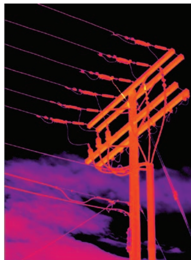
Đứt dây điện và trở kháng cao.
