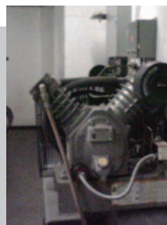
Luchtcompressor - volledig zichtbaar
