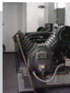
Luftkompressor – fullt synlig
