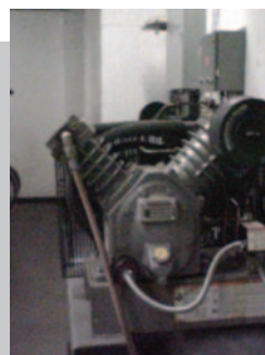
Compressor de ar – Totalmente visível
