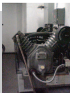
Compresseur d'air - Image visible intégrale
