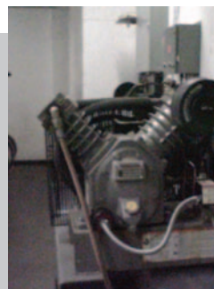
Kompresor Udara – Tampak Penuh
