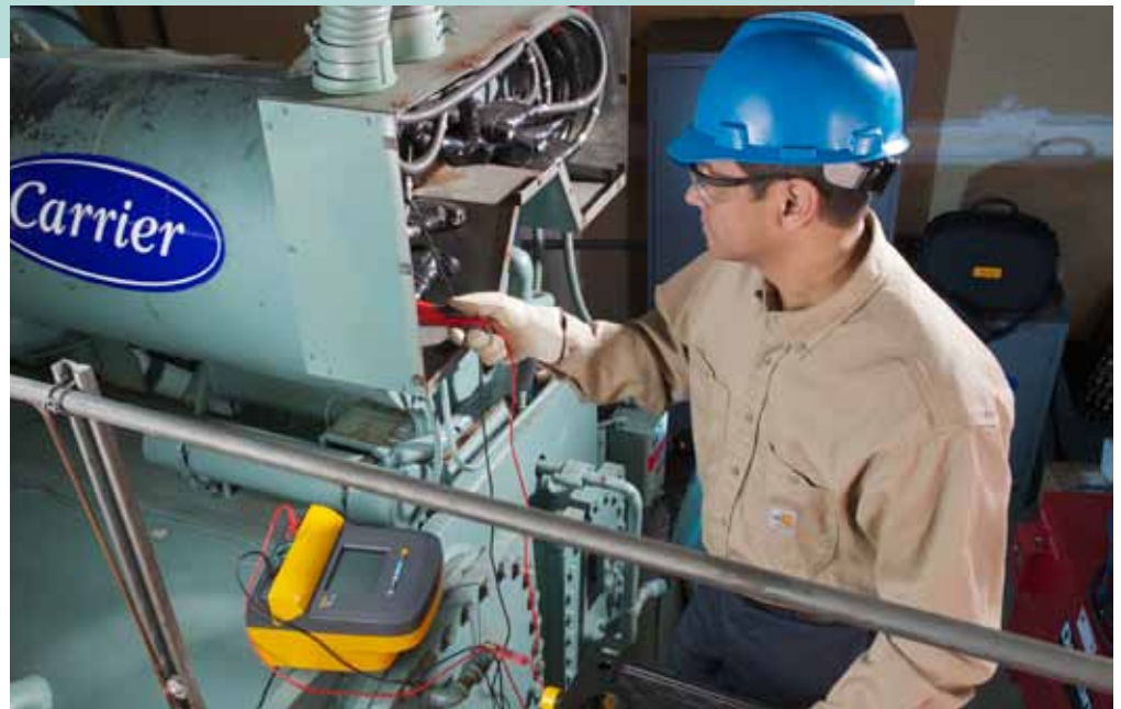
Puede utilizar una cámara termográfica, como esta Fluke Ti105, para comprobar diversas partes de un sistema de caldera.
