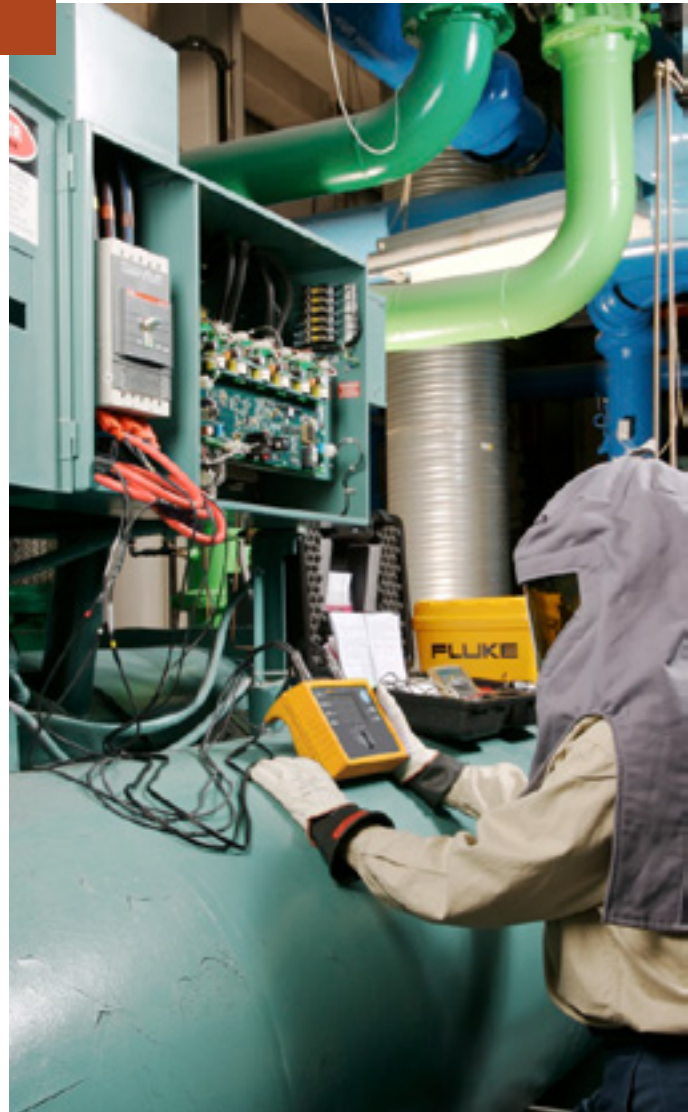
Fluke 1735 Power Logger를 사용해 칠러(chiller)의 전력 소모량을 기록함으로써 장비 효율성을 판단합니다.
