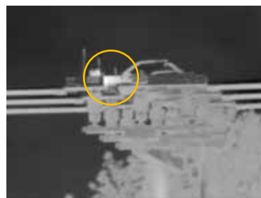
图 6：使用福禄克 4 倍长焦镜头捕获的变电站输电线的第三张图像，清楚地显示了闸刀开关上有一个热点或高电阻。
