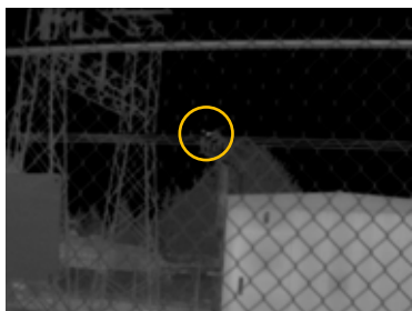
图 4：使用 TiX560 热像仪和标准镜头对变电站外部设备进行外部扫描发现其中一个相位开关存在异常。
