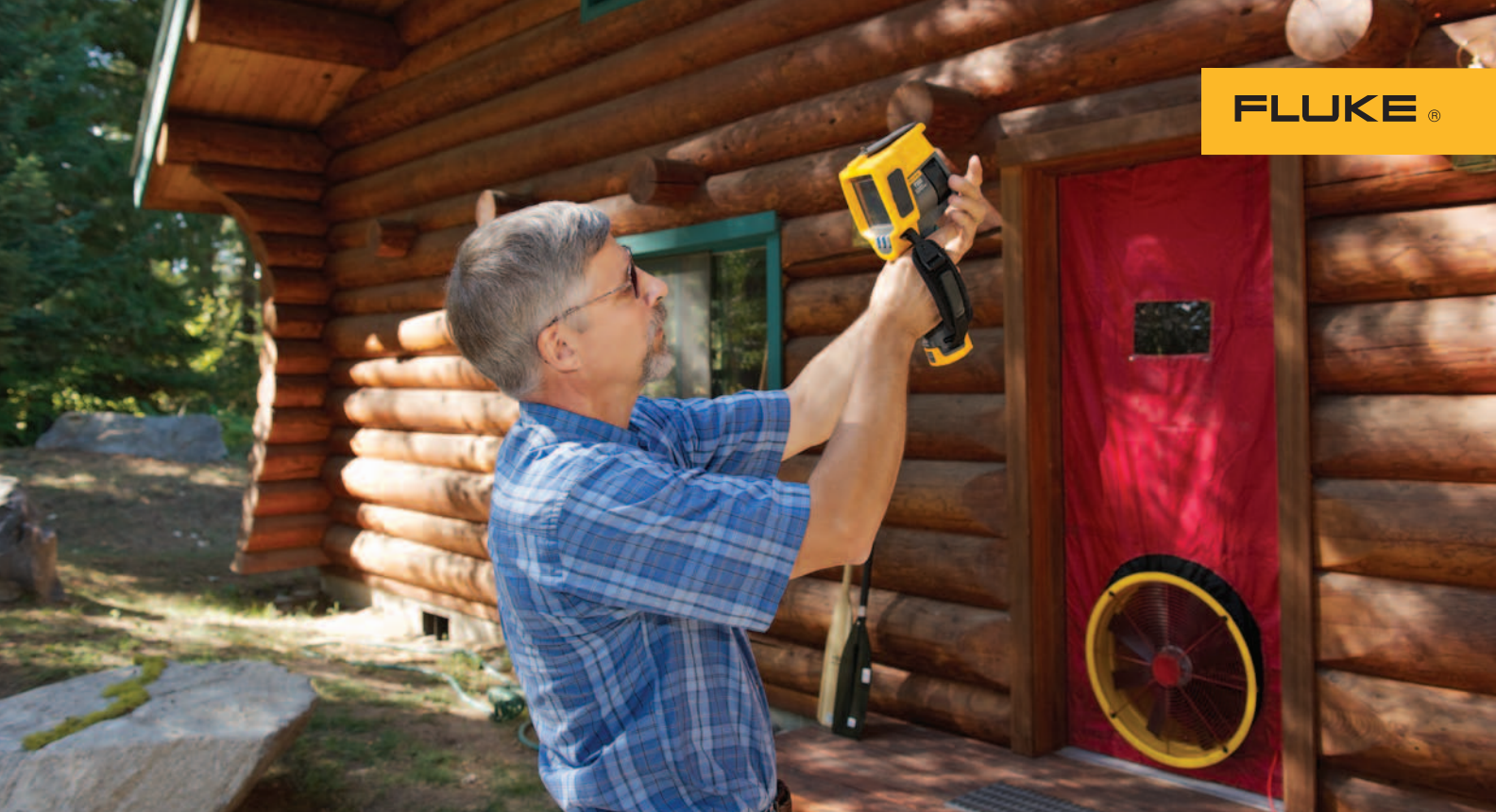
Abbildung 7: Einsatz einer Wärmekamera in Verbindung mit einem zeitweilig installierten Blower-Door-Gerät zur Suche nach austretender Luft. Hierbei ist der Einfluss der Sonneneinstrahlung zu berücksichtigen.
