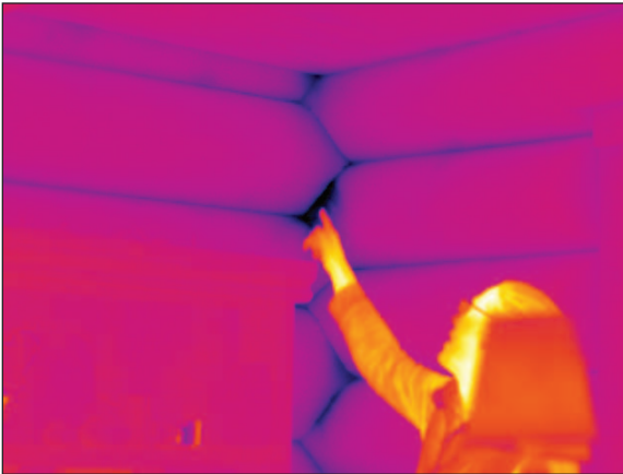
Abbildung 5: Der Hauseigentümer weist auf eindringende kalte Luft hin.
