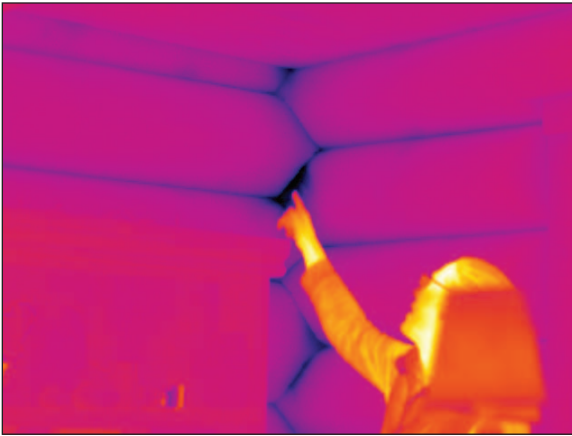
Figura 5. El propietario de la vivienda señala la infiltración de aire frío.
