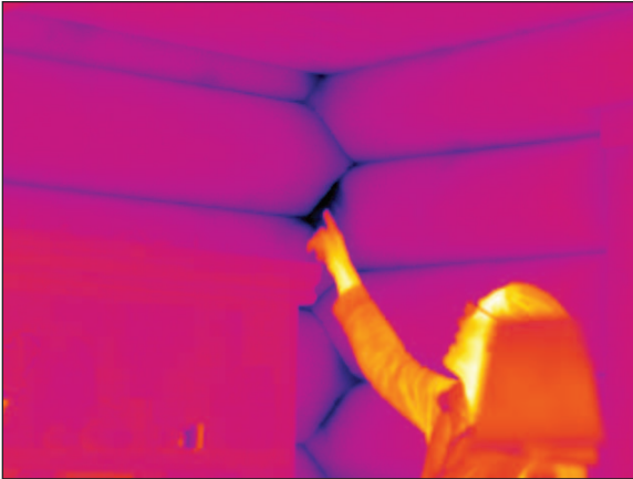
Figura 5. Il proprietario segnala l'infiltrazione di aria fredda.
