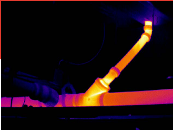
La imagen infrarroja muestra un bloqueo parcial en una línea de drenaje de líquido de desecho industrial. Si no se detecta correctamente un deterioro de la situación, se pueden producir problemas graves.
