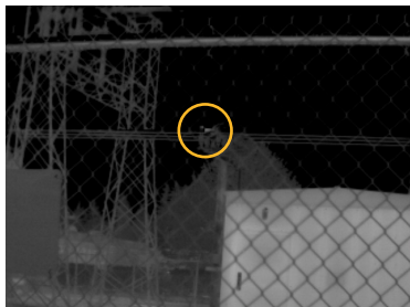
Figura 4: Uma análise externa de um equipamento externo em uma subestação com um termovisor TiX560 e uma lente padrão capturou uma avaria em uma das chaves de fase.
