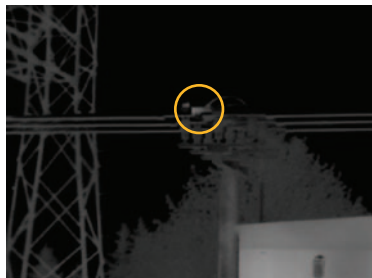
Figure 5 : En inspectant la même zone avec un téléobjectif Fluke 2x, on voit clairement la présence d'un point chaud sur l'inverseur.
