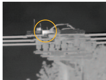
Figure 6 : Cette troisième image de la ligne de transmission du poste électrique, capturée avec un téléobjectif Fluke 4x, montre clairement un point chaud ou une résistance élevée sur un interrupteur à couteau.
