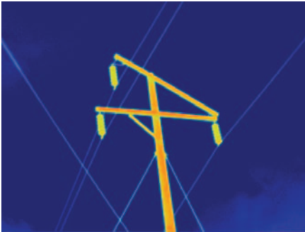
Figure 7 : poteau électrique haute tension, capturé avec une caméra TiX560 et un objectif standard.
