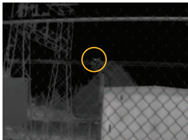
Figure 4 : L'inspection extérieure de l'équipement extérieur d'un poste électrique avec une caméra thermique TiX560 et un objectif standard a permis de capturer une anomalie sur un des inverseurs de phase.
